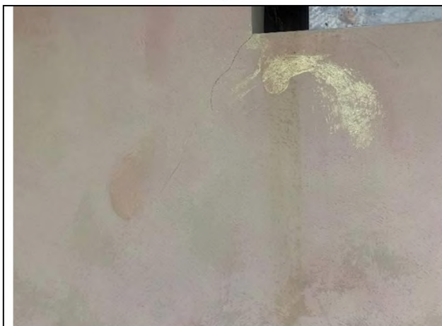
Трещина штукатурного слоя в пом. № 9
