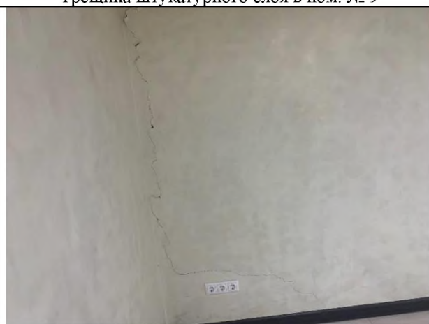
Трещина штукатурного слоя в пом. № 9
