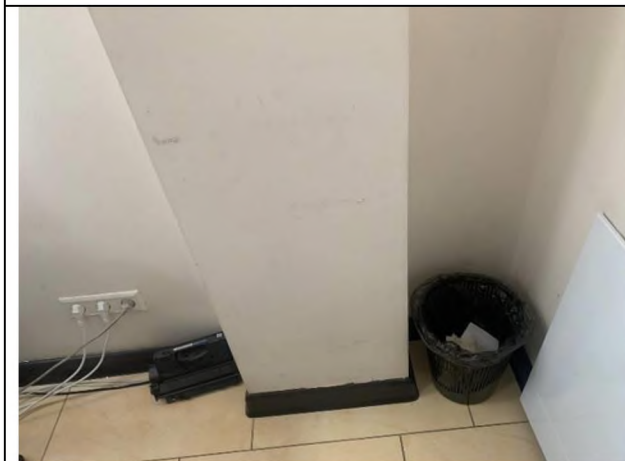
Повреждение и загрязнение отделки стен в пом. № 23
