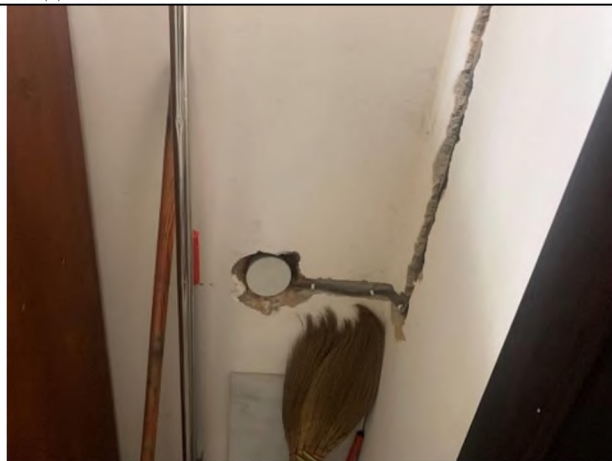
Отсутствие заделки штукатуркой штробы под электропроводку в помещении под лестницей
