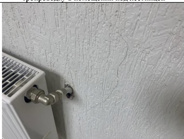
Трещина штукатурного слоя в пом. № 14
