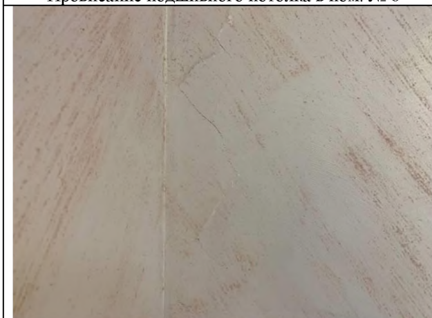
Трещина штукатурного слоя в пом. № 8
