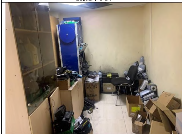
Загрязнение отделки стен в пом. № 14
