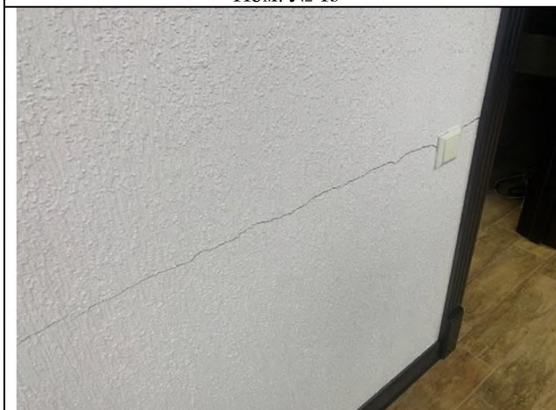
Трещина в штукатурном слое в пом. № 13
