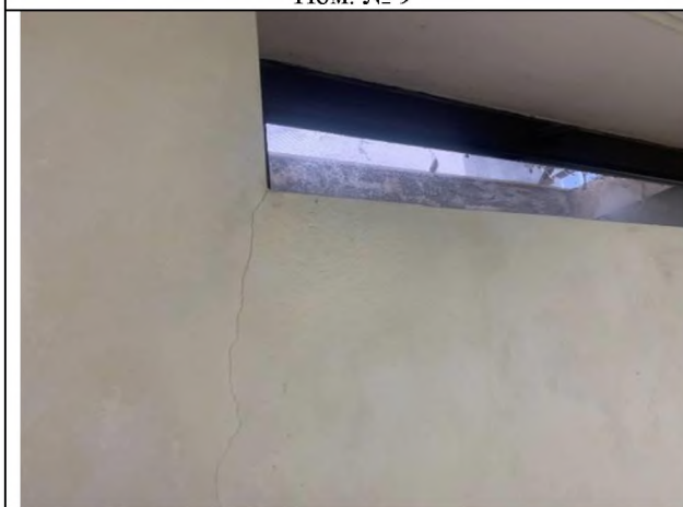
Трещина штукатурного слоя в пом. № 9
