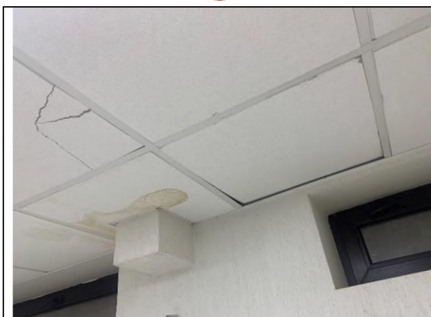
Поврежденные потолочных панелей, следы протечек в пом. № 4
