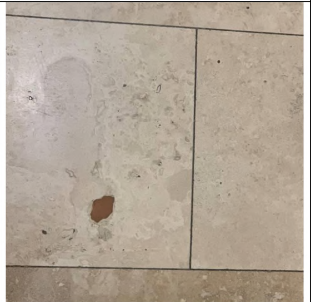
Повреждение напольного покрытия в пом. № 1
