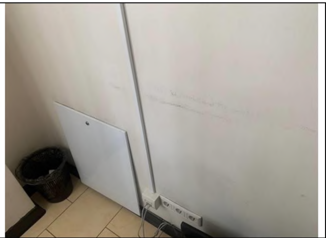
Повреждение и загрязнение отделки стен в пом. № 23
