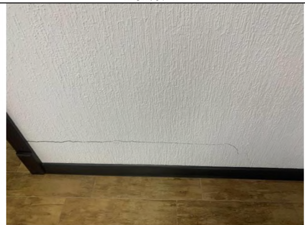
Трещина в штукатурном слое в пом. № 13
