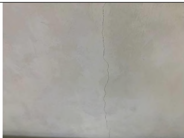
Трещина штукатурного слоя в пом. № 9
