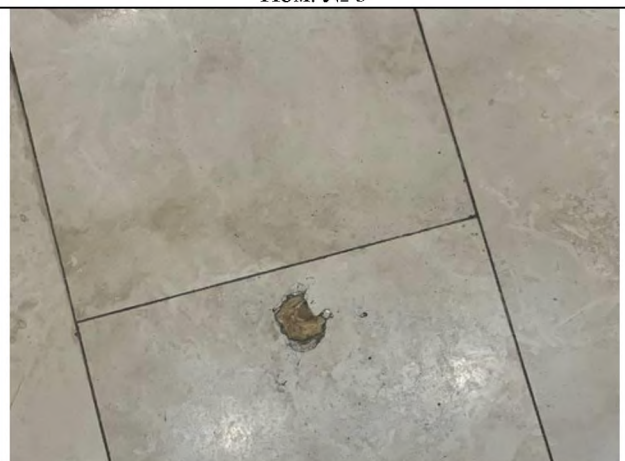
Повреждение напольного покрытия в пом. № 1
