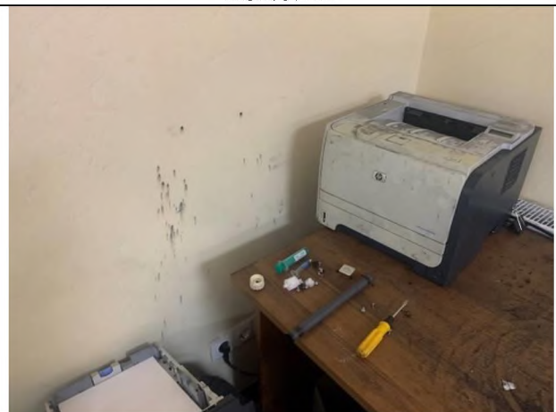
Загрязнение отделки стен в пом. № 14
